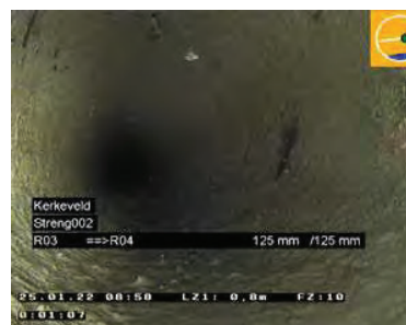
Abb. 9: Beispiel für Sedimente auf der gesamten Kanaloberfläche
