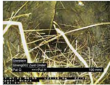
Abb. 10: Beispiel für in den Kanal hineinwachsende Haarwurzeln
